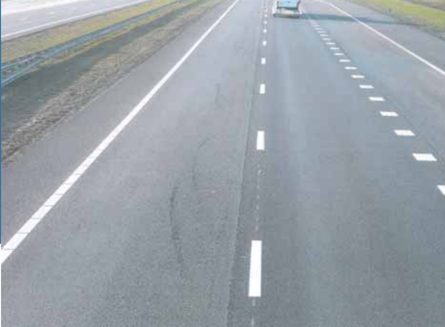
Voorbeeld van walsschade op naastliggende linker rijstrook.
